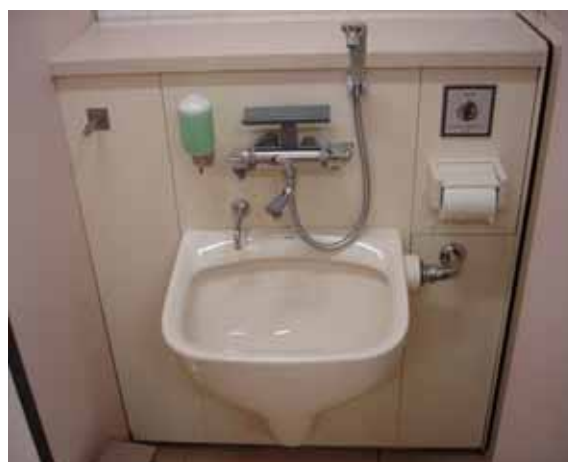
【トイレブース内】 （設置例）
